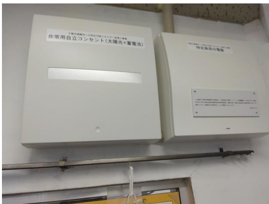
非常用自立コンセント（太陽光＋蓄電池）
