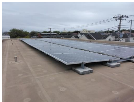
公民館屋上のソーラーパネル
